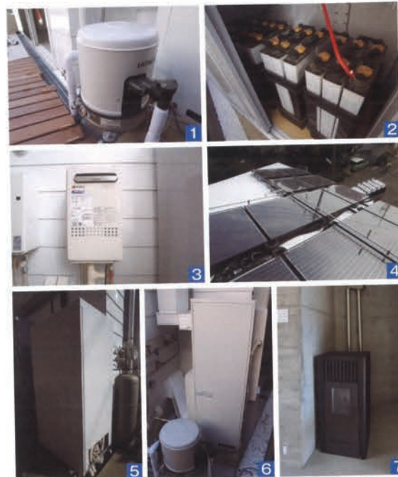
1.井戸水利用システム。屋根上のパネルに散水し冷却や洗浄する機能も有する。 2.フォークリフトやゴルフカートに使用されたバッテリーを有効活用 3.補助熱源のエコジョーズ 4.GF技研製の太陽光・太陽熱ハイブリッドシステム 5.ハイブリッドパネルの熱を溜める貯湯タンク 6.ハイブリッドパネルを活用した空調システム 7.ペレットストーブ
